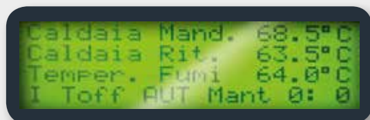
Lettura delle sonde di mandata, ritorno caldaia, temperatura dei fumi.
