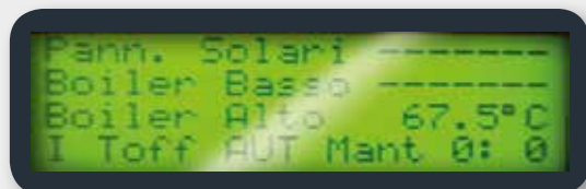
Lettura delle sonde dei pannelli solari, e nei punti basso ed alto del boiler o accumulatore.
